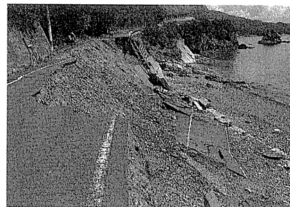
平成16年台風18号の被害（加周）
