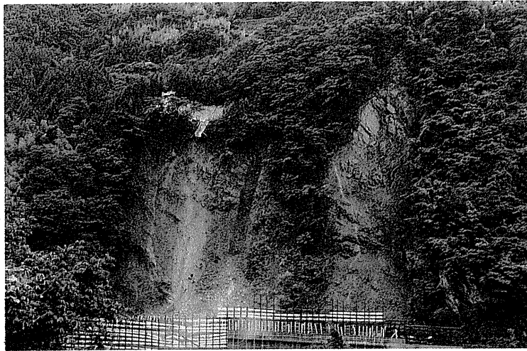
写真3-4 昭和54年7月11日、斜面中央付近で小崩落が断続的に発生している
