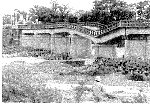
図16 陥没した日開谷橋
