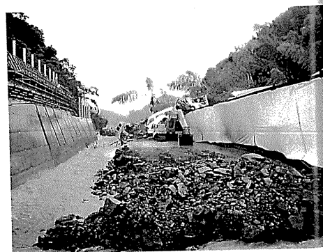
被災状況③（起点側より）
