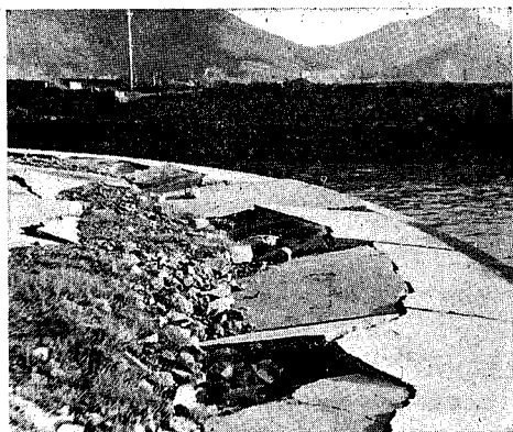
南海地震による鞆奥町の護岸の崩壊
