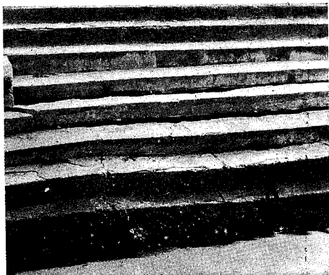
大川郡三本松港の物揚場石段 （地震による直接被害）
