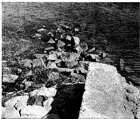
キジア颱風時の高潮により破壊された 鞆奥町の突堤
