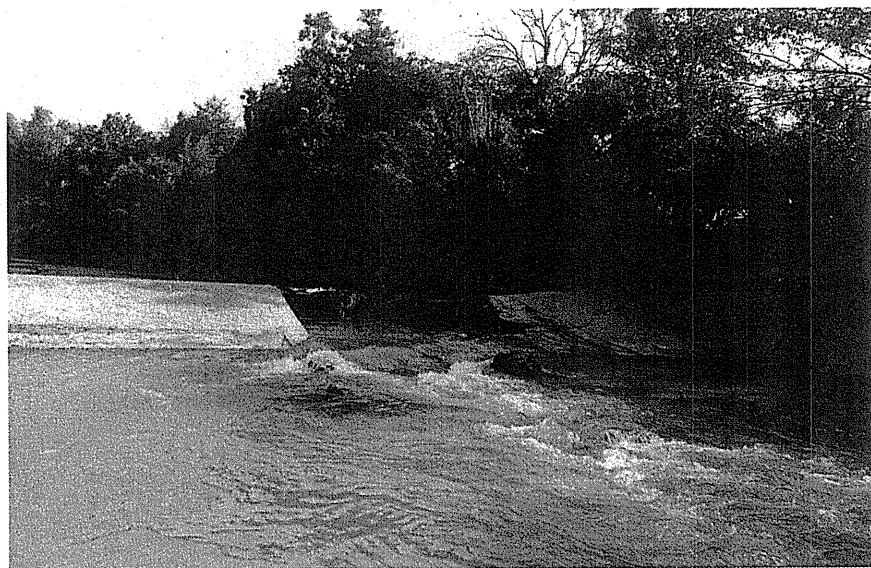
頭首工流失 (新川 上新川堰)
