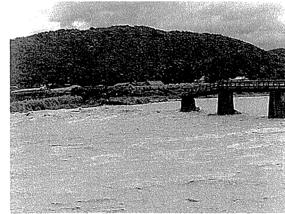
昭和50年8月22日の台風6号で乙井橋流失（満濃町）
