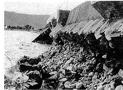
増水により破壊したブロック護岸（満濃町長尾地区） （昭和50年8月22日）
