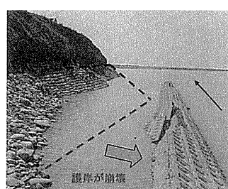
昭和38年8月洪水による護岸崩壊（香南市吉原地先）……④
