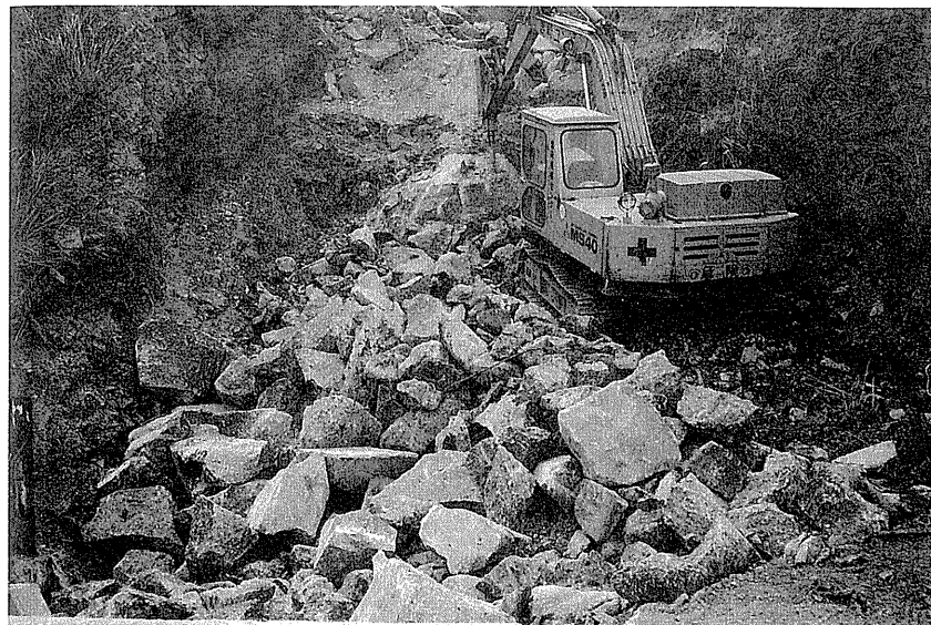
国道11号 鳴門市北灘町 昭和51年（被災状況）
