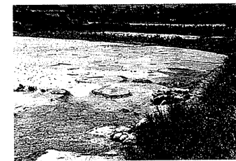
基礎漏水の結果、堤内地に穴が開いた状況(昭和29年9月)
