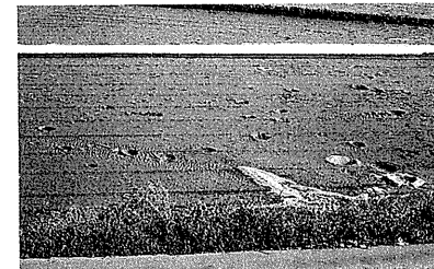
漏水 石井町西覚円(平成2年9月)
