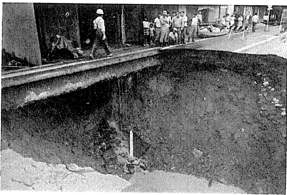
陥没した道路(白地・昭和49・9)
