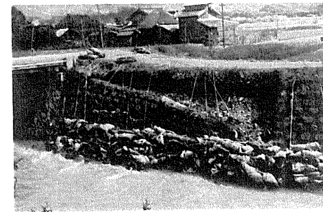
無残な崩壊護岸
