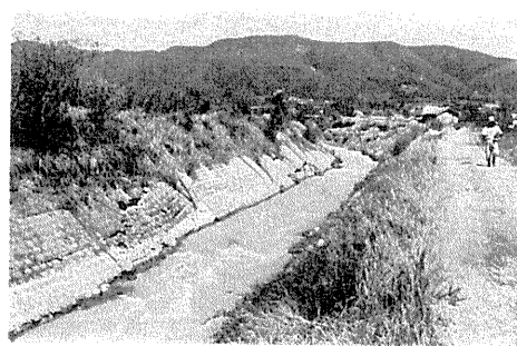
大場橋下流護岸崩壊
