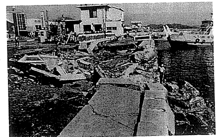
2 片原町海岸の被害
