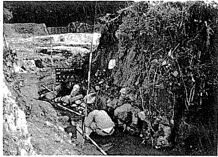
大谷中池被災の状況
