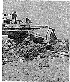
傾き折れた二宮橋
